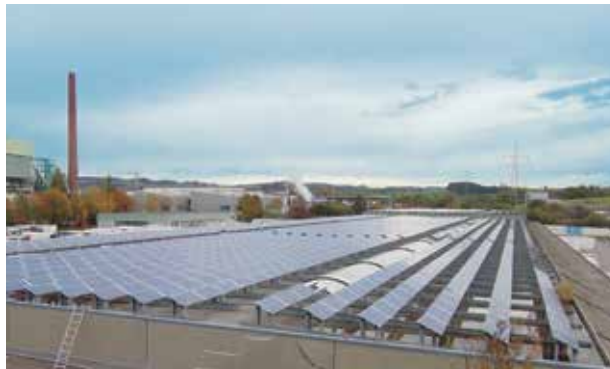
324 kW-Anlage Lebert in Kempten
