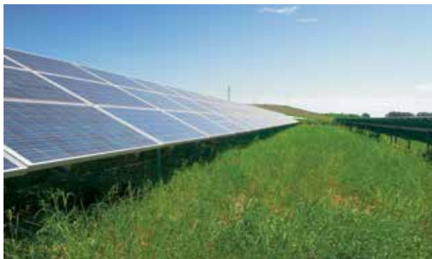
662 kW-Anlage El Trujillo in Andalusien
